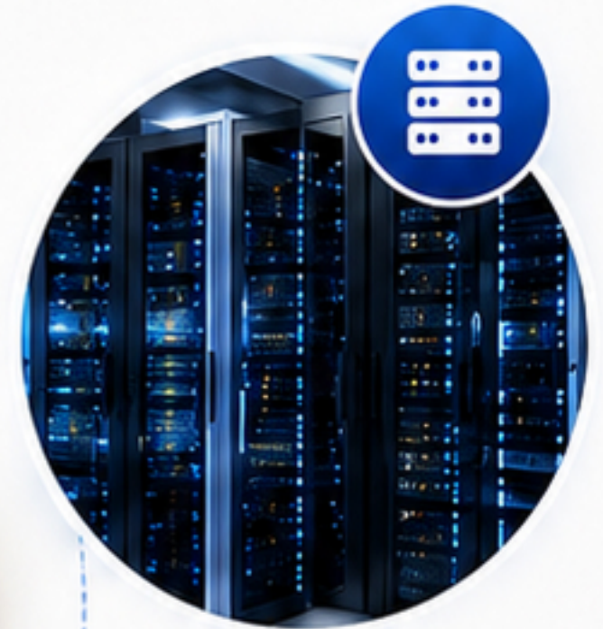
Salas De Servidores
